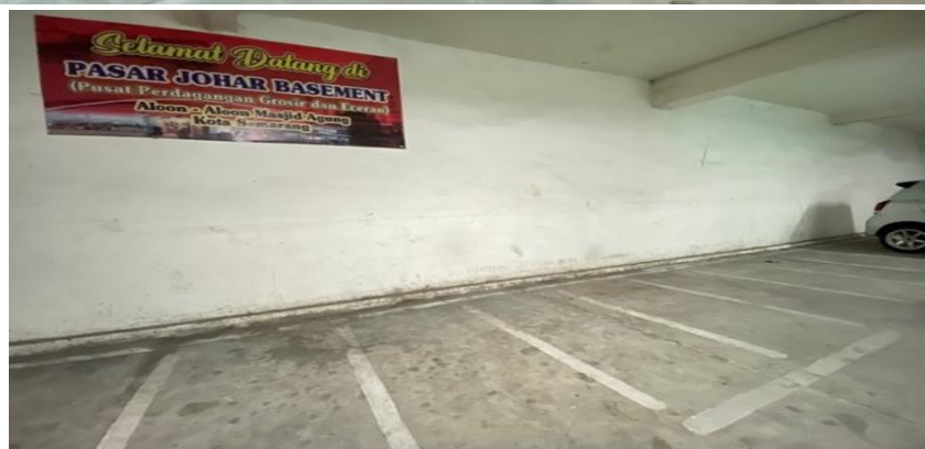
Gambar 4. Kondisi Marka pada Lantai Basement
