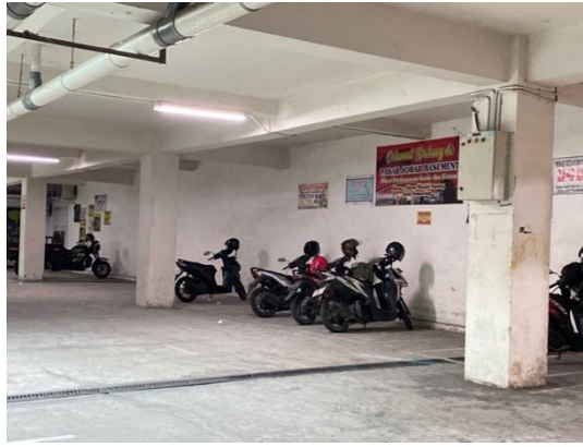
Gambar 7. Pencahayaan Tambahan Basement dicapai dengan Pemasangan Lampu LED Pada Langit-Langit Basement
