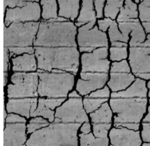
Gambar 6. Visualisasi kerusakan total/ complete damage pada seismostruct
